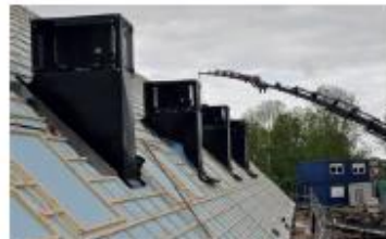
Warmtepomp in schoorsteen
