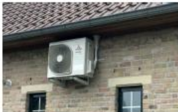
Warmtepomp aan gevel in zicht
