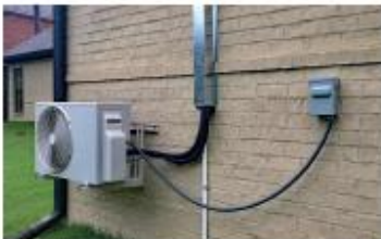
Losse kabels bij warmtepomp
