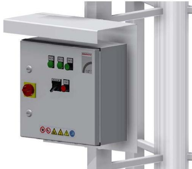
Afbeelding 41: Schakelkast met teststicker en waarschuwingstickers
