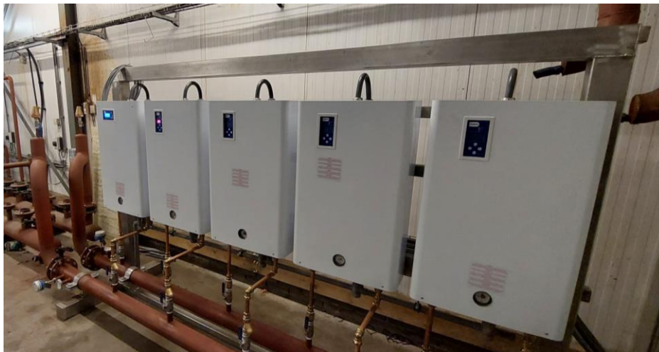
Afbeelding 3 – Foto elektrische boilers
